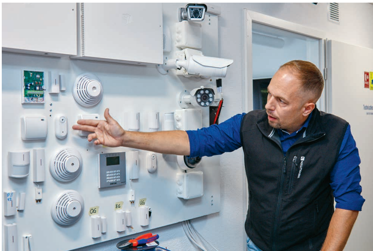
Sur le mur de montage, il est possible de s'exercer à détecter des erreurs ou à connecter des systèmes.
