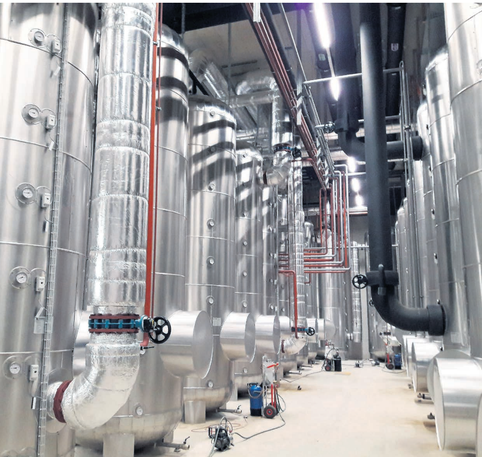
Kernkompetenz von Matica ist die Produktion von Stahltanks, die es für das Speichern des Warmwassers braucht.
